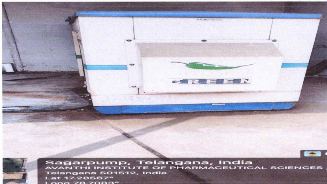
FIG: 7 DG-SET 62.5KV
