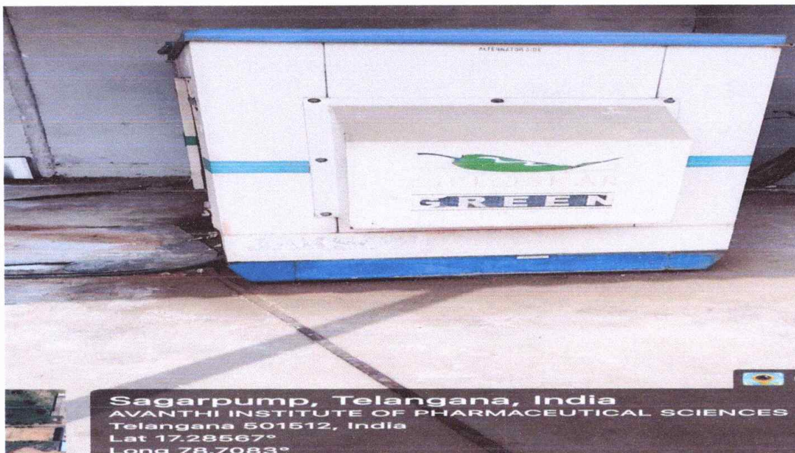
FIG: 7 DG-SET 62.5KV
