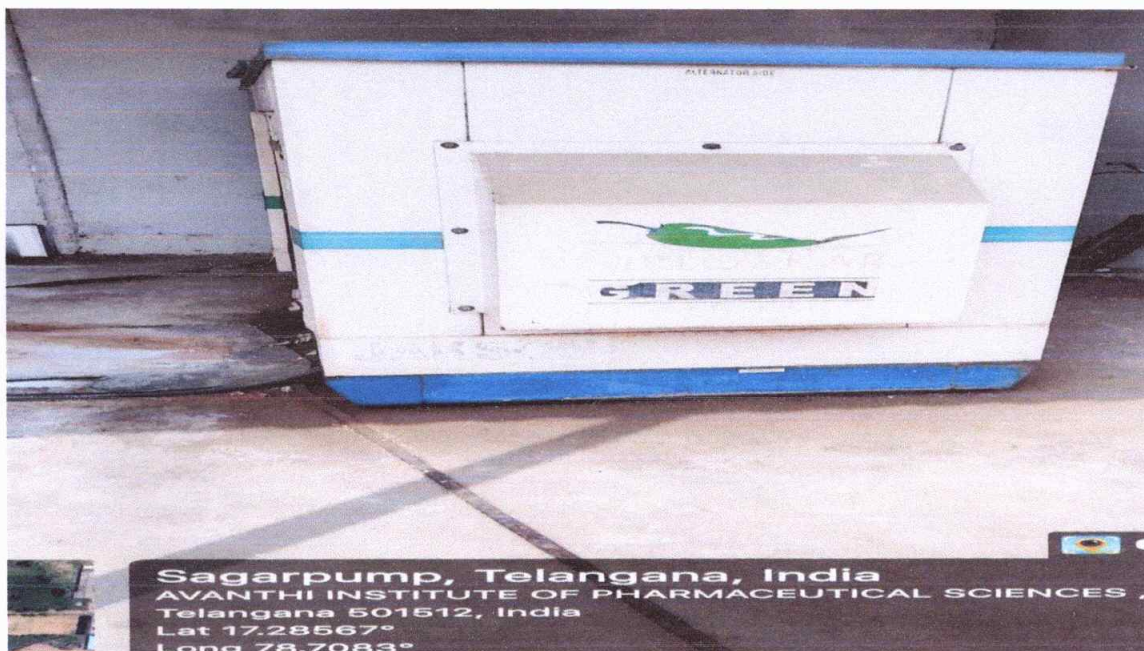
FIG: 7 DG-SET 62.5KV
