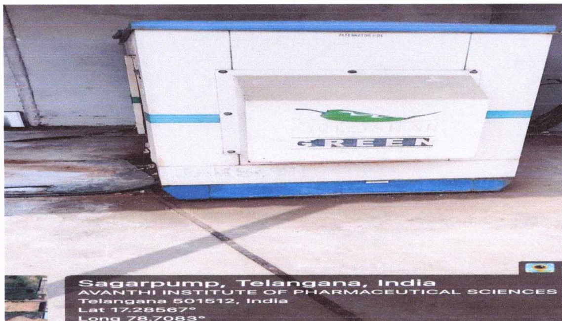
FIG: 7 DG-SET 62.5KV
